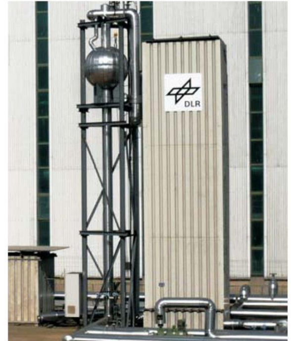
Latentwärmespeicher im Testbetrieb in Carboneras, Spanien (14 t \text{NaNO}_3 , Phasenwechsel bei 305 °C)
